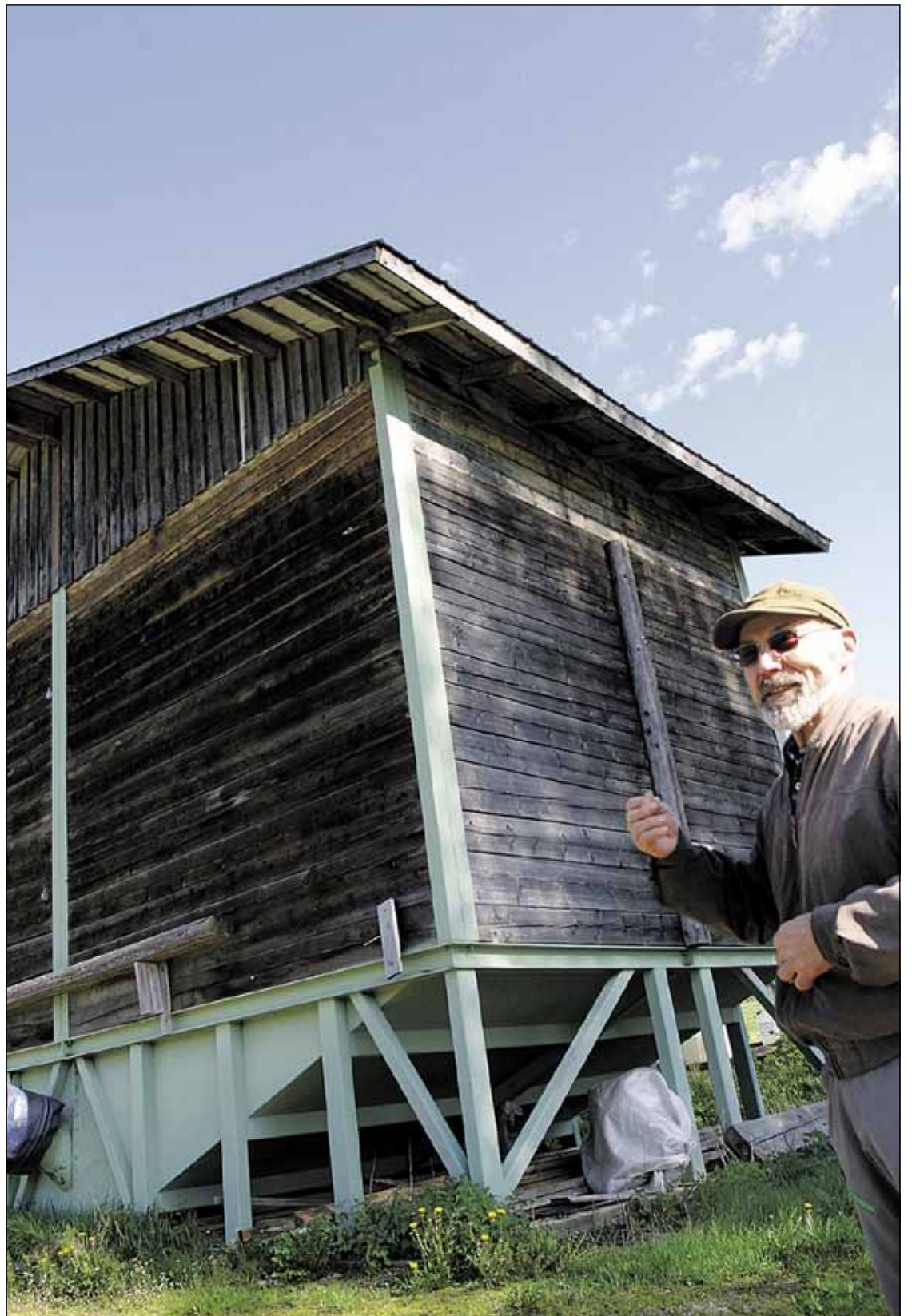
Lapinahon viljavarastossa on seinät hirrestä. Jouko Makkonen sai idean manttaalikuntien lainajyvästöstä, jotka oli veistetty hirsistä. Uuden ajan vilja-aitta on kuitenkin rakennettu pilaripalkkitekniikkaa hyväksikäyttäen. Pilarikehys on metallia ja seinät on ladottu hirsistä. Puinen viljavarasto on erinomainen leipäviljan säilytykseen.
